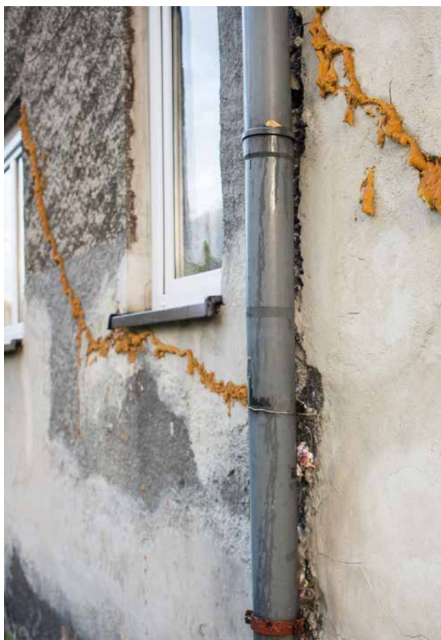
Praskliny na domě v Bytomské čtvrti Miechowice.
